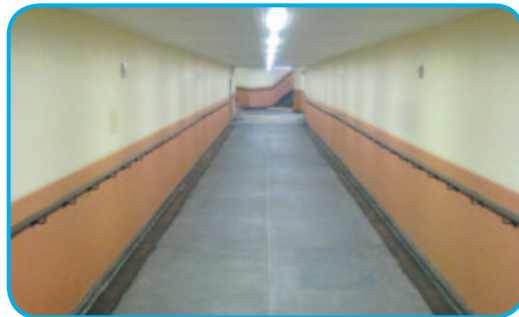
有待優化的行人隧道 Subway to be enhanced
