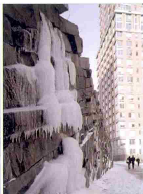
图11 冬季石墙渗水凝结的冰景
