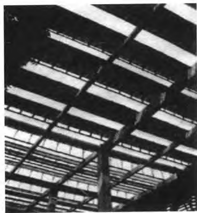
图1 屋顶太阳能和光伏遮阳板
