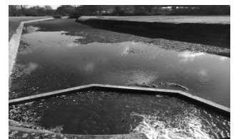
图 2 地表水预处理单元——慢滤沙池
