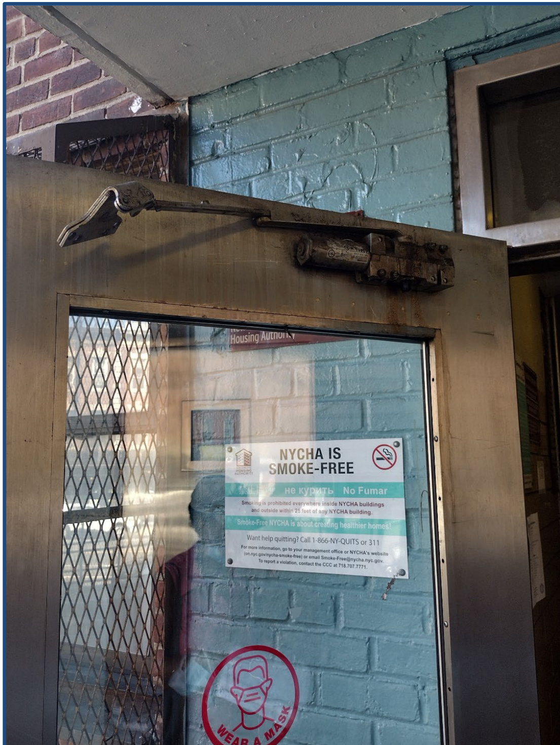
Broken Door Closer
